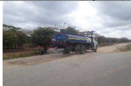
Fotografía 48. Actividad de riego de la vía de acceso a las locaciones Istanbul y Aruchara. E: 5025718 – N: 2817945 (Origen Único)
