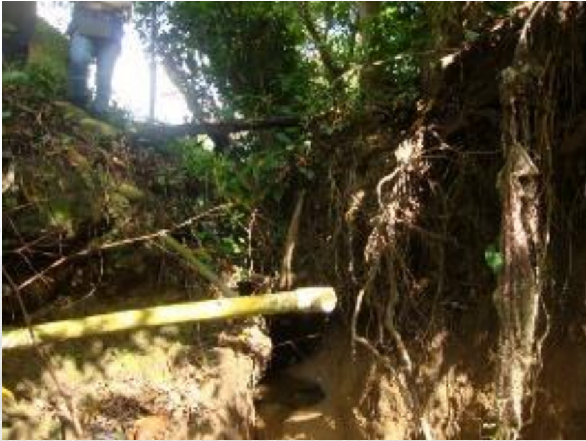
Raíces expuestas de individuos arbóreos en taludes aledaños al canal de desagüe - Coordenadas planas origen único nacional Este 4952788,818 Norte 2343609,206.
