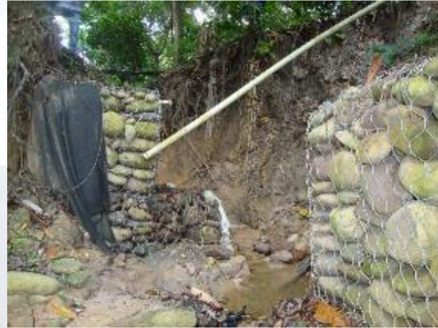
Raíces expuestas de individuos aledañas a muros gavionados de obras de descole sin culminar Coordenadas planas origen único nacional Este 4952778,835 Norte 2343618,673.
