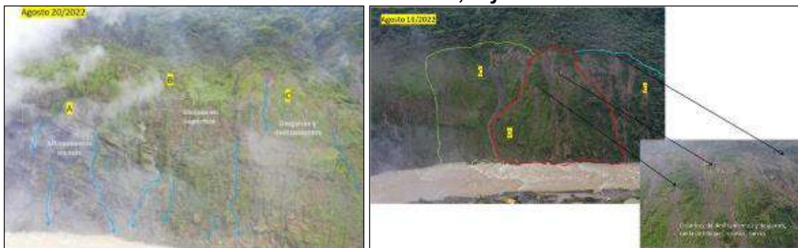
Figura 59 Surcos y agua de escorrentía en los sectores A, B y C. Erosión concentrada en los sectores C, D y E
