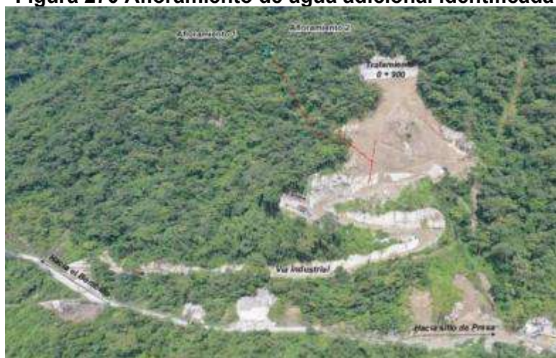
Figura 270 Afloramiento de agua adicional identificada
