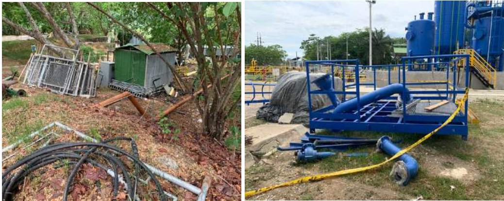
Partes de infraestructura dispuestas de forma incorrecta E 01199343 N 00919791 Datum magna sirgas Origen Bogotá
