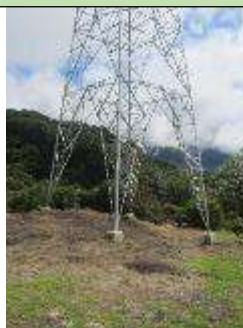
Fotografía 52. Torre 128NN, rastro por el paso del agua centro de torre coordenadas origen único, E 4926235.691 N2121936.088
