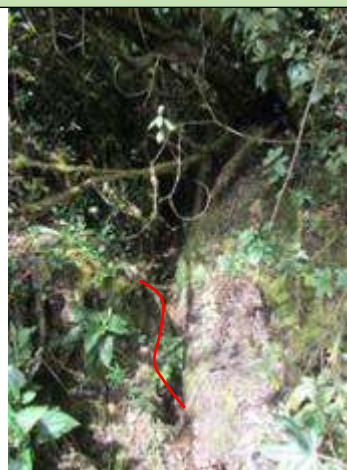
Fotografía 51. Torre 128NN, caída de material de excavación cerca al cuerpo de agua, coordenadas origen único, E 4926230.703 N2121941.093
