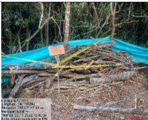
Fotografía 82. Torre 106 - RFPP de la Cuenca Alta del Río Bogotá- aislamiento y señalización
