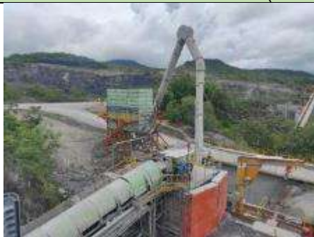
Fotografía Planta de trituración Secundaria. Mina La Esmeralda. 4766437.928E 2032958.283N MS(CTM12)
