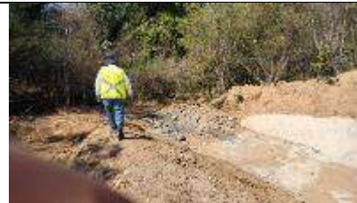
Fotografía 34. Canal de descarga al río Tucuytito Coordenadas Origen Único Nacional (E: 4970267 – N: 2620186)
