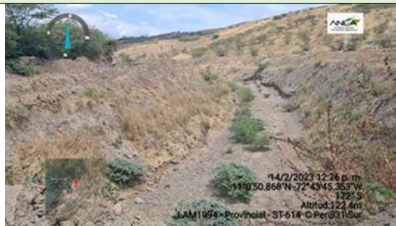
Fotografía 32. Estado del canal perimetral Coordenadas Magna Sirgas, origen Único E 5061743.176 - N2779127.100
