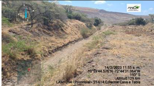
Fotografía 17. Estado de canal perimetral Coordenadas Magna Sirgas, origen Único E 5060896.077 - N 2728767.946
