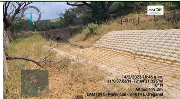
Fotografía 13. Fin canal de descarga aprox. 30 m, antes de la descarga al Río Ranchería Coordenadas Magna Sirgas, origen Único E 5060806.847 - N 2777688.429
