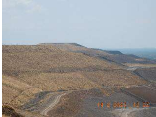
Fotografía 40. Etapa de estabilización – Botadero aeropuerto Coordenadas Magna Sirgas, origen Único E 530358.53 - N 2775593.81
