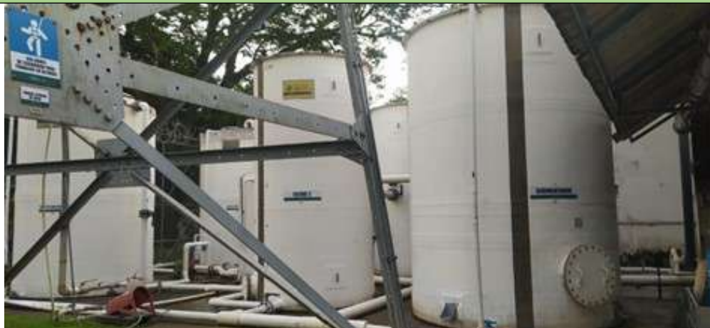
Figura 164. Planta de tratamiento de agua en el laboratorio de beneficio de oro. Fuente: Equipo Técnico de Seguimiento durante la visita de seguimiento llevada a cabo del 5 al 11 de julio de 2022.
