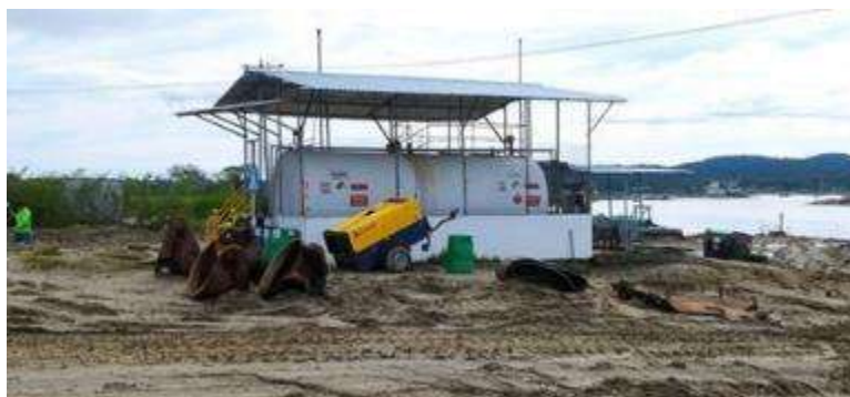
Figura 25. Tanque de almacenamiento de combustible ubicado en el punto logístico. Fuente: Equipo Técnico de Seguimiento durante la visita de seguimiento llevada a cabo del 5 al 11 de julio de 2022.
