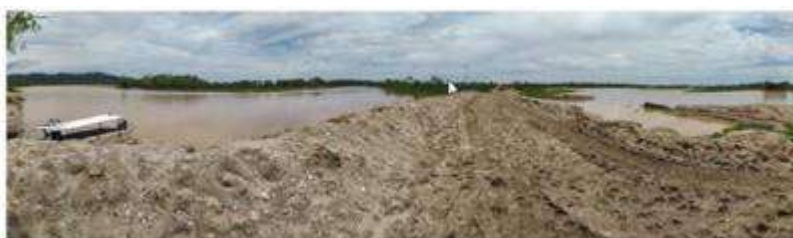
Fotografía 3 Estado actual jarillón Puerto Arenas. Coordenadas Origen Único Nacional: E: 4802927,596 y N: 2429016,7480
