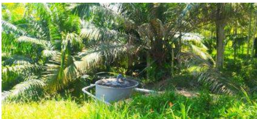
Figura 22. Sistema séptico descentralizado en el campamento de la Sociedad. Fuente: Equipo Técnico de Seguimiento durante la visita de seguimiento llevada a cabo del 5 al 11 de julio de 2022.
