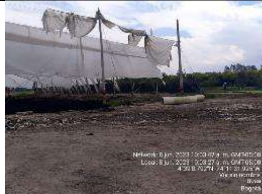
Fotografía 24. Perdida de la cubierta del invernadero
