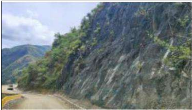
Figura PMA 13 – 17. Talud K2+200 – K2+240 - Jun 2024.
