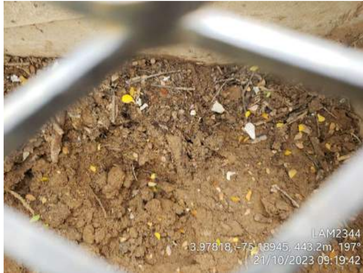
Fotografía 150. Ortega 9. Desarenador ubicado en la esquina Noreste de la plataforma. Nótese la estructura parcialmente colmatada de sedimentos y materia vegetal. Coordenadas Origen Único Nacional – E: 4756988 N: 1997915.
