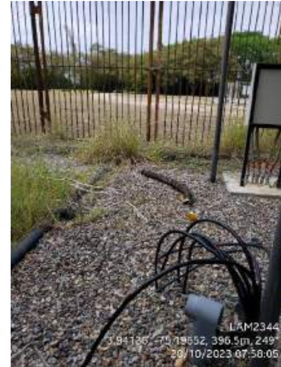
Fotografía 162. Plataforma Ortega Sur 1. Antigua caseta de equipos eléctricos. Nótese la presencia de manguera y tubería metálica abandonada sobre el suelo. Coordenadas Origen Único Nacional – E: 4756193 N: 1993842.
