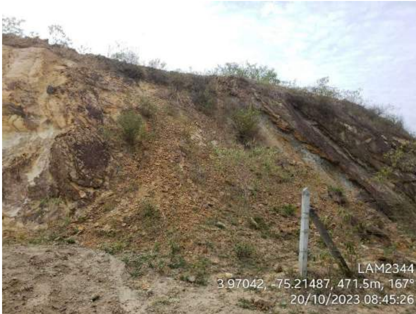
Fotografía 77. Vía de acceso plataforma Don Pedro CPI. Talud de corte con desprendimiento de material. Nótese la acumulación de fragmentos de roca y sedimentos en la pata del talud. Coordenadas Origen Único Nacional – E: 4754170 N: 1997062.
