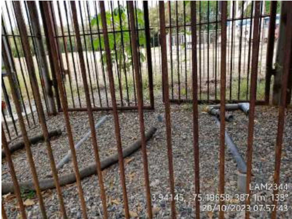
Fotografía 161. Plataforma Ortega Sur 1. Antigua caseta de equipos eléctricos. Nótese la presencia de manguera y tubería abandonada sobre el suelo. Coordenadas Origen Único Nacional – E: 4756190 N: 1993844.
