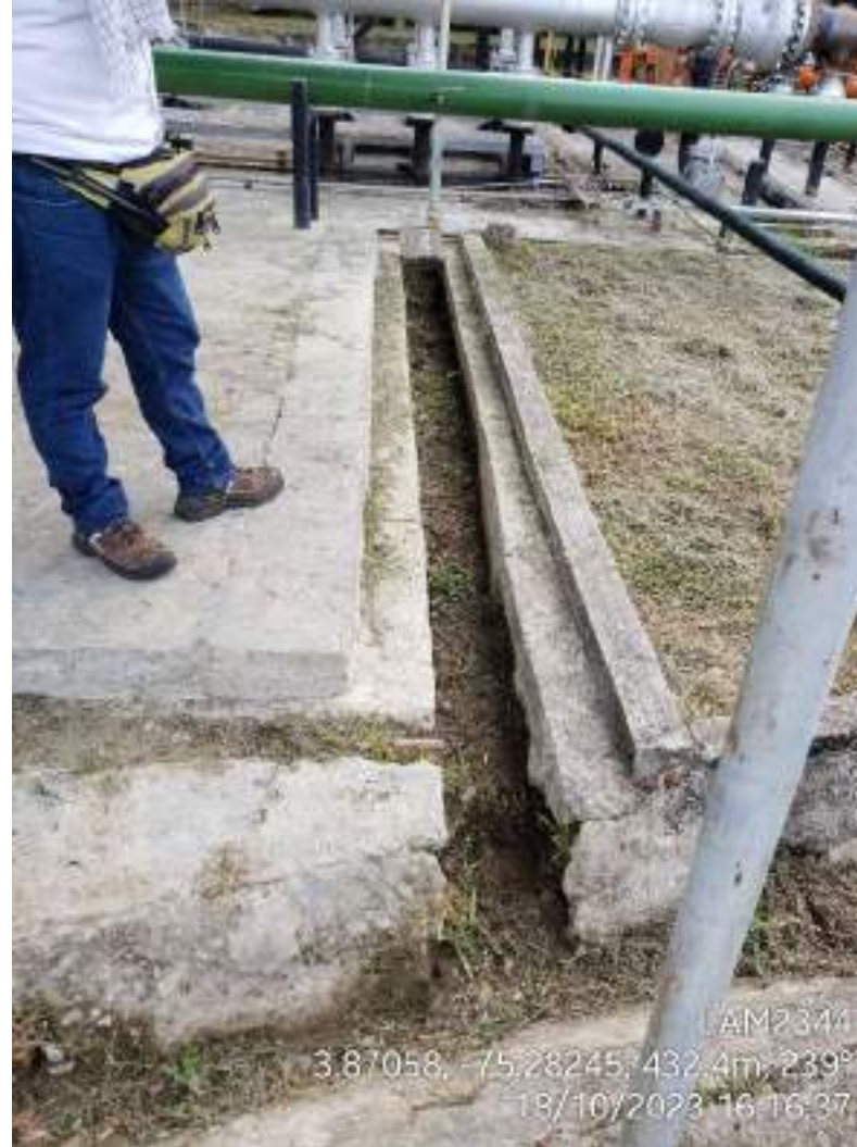
Fotografía 92. Estación Toldado. Área de manifold. Nótese la conexión entre cárcamo proveniente del manifold con cuneta de aguas lluvia. Coordenadas Origen Único Nacional – E: 4746642 N: 1986045.
