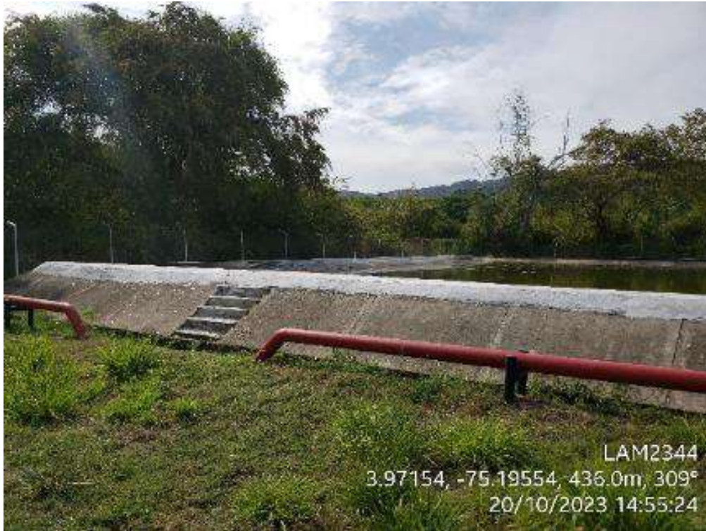
Fotografía 235. Estación Santa Rita. Nótese la ausencia de señalización en el área de la piscina contra incendios. Coordenadas Origen Único Nacional – E: 4756307 N: 1997179.
