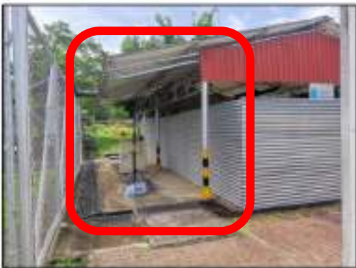
ER9: Generador Respaldo Estación Toldado
