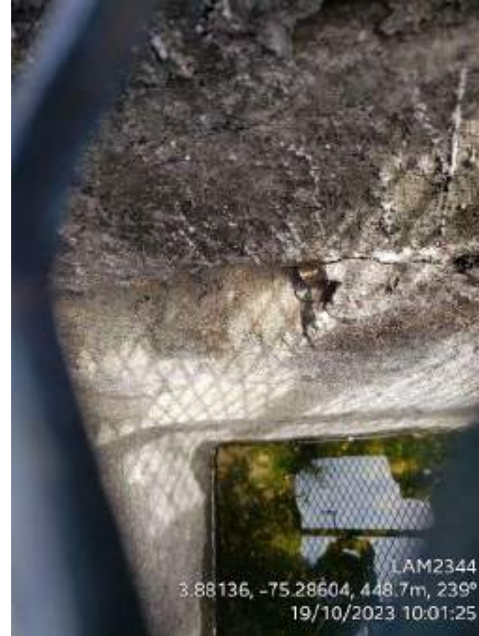
Fotografía 68. Plataforma Toldado 11. Nótese el contrapozo fracturado. Coordenadas Origen Único Nacional – E: 4746237 N: 1987236.
