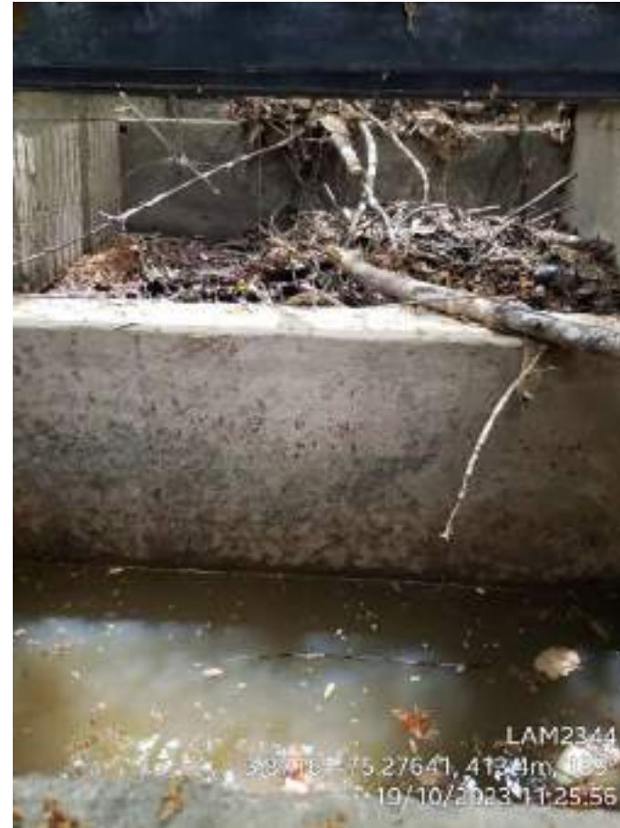
Fotografía 147. Toldado 4. Desarenador ubicado en la esquina Sureste de la plataforma. Nótese la estructura completamente colmatada de sedimentos y material vegetal. Coordenadas Origen Único Nacional – E: 4747295 N: 1986160.
