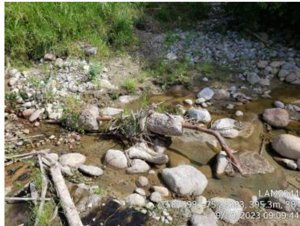
Fotografía 246. Cruce subfluvial del río Peralonso. Nótese la existencia de tubería de líneas de flujo abandonadas sobre el cauce del río. Coordenadas Origen Único Nacional – E: 4746479 N: 1986631.
