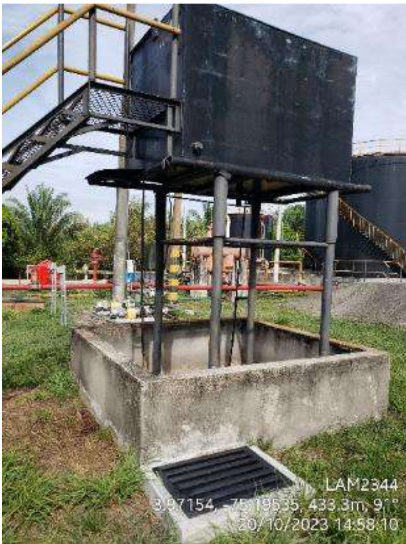
Fotografía 38. Estación Santa Rita. Tanque de almacenamiento de ACPM. Nótese el tanque ubicado dentro de un dique perimetral en concreto; el dique cuenta con conducto de drenaje hacia una trampa de grasas. Coordenadas Origen Único Nacional – E: 4756321 N: 1997181.
