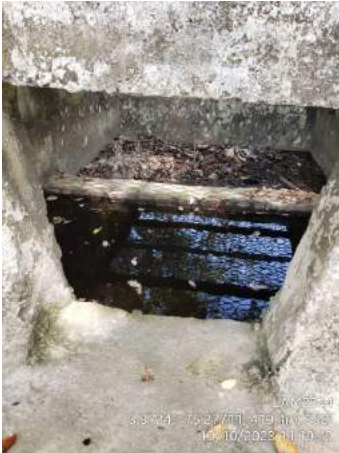
Fotografía 146. Toldado 4. Desarenador ubicado al costado Norte de la plataforma. Nótese la estructura completamente colmatada de sedimentos y material vegetal. Coordenadas Origen Único Nacional – E: 4747225 N: 1986241.
