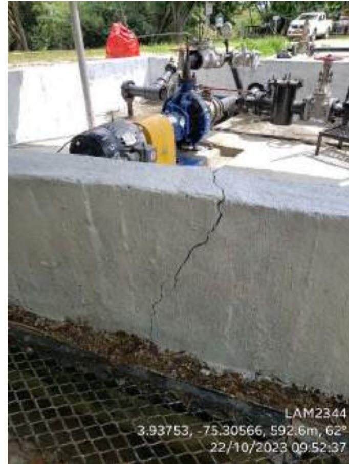
Fotografía 66. Estación Toy. Dique de las bombas utilizadas para el cargue de crudo. Nótese la pared del dique en concreto fracturada. Coordenadas Origen Único Nacional – E: 4744070 N: 1993452.
