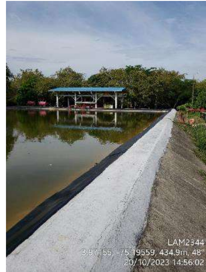
Fotografía 236. Estación Santa Rita. Nótese la ausencia de señalización en el área de la piscina contra incendios. Coordenadas Origen Único Nacional – E: 4756299 N: 1997180.
