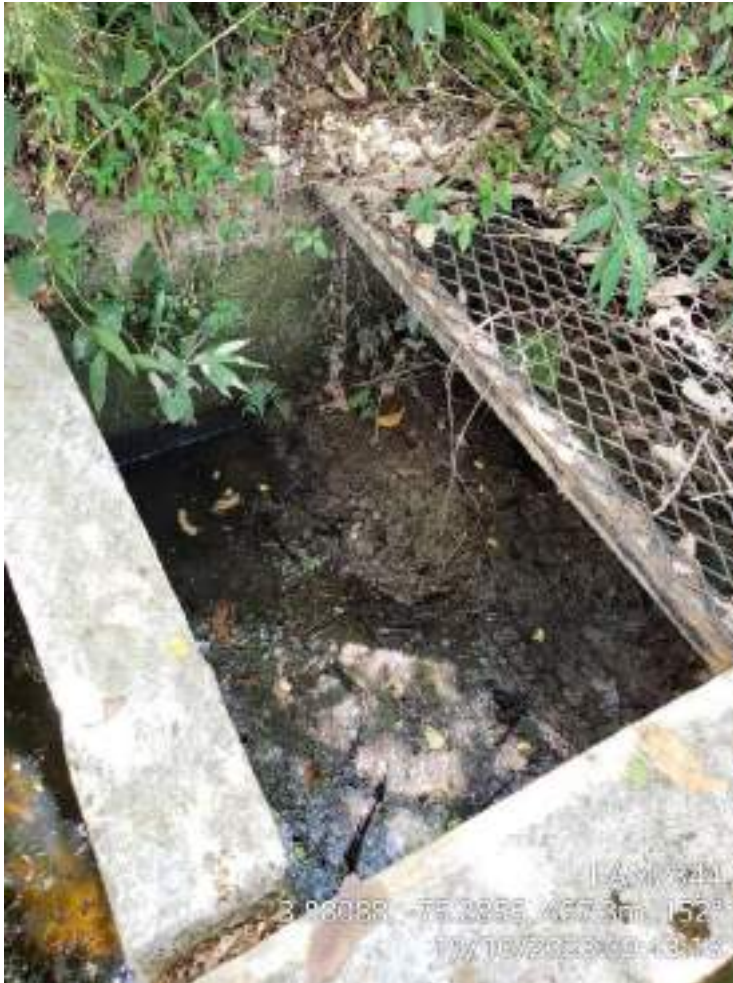
Fotografía 145. Toldado 11. Desarenador ubicado al costado Sureste de la plataforma. Nótese la estructura completamente colmatada de sedimentos. Coordenadas Origen Único Nacional – E: 4746289 N: 1987183.
