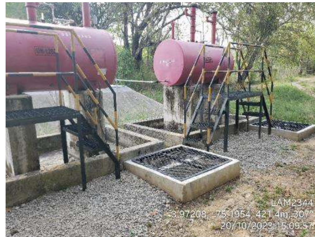
Fotografía 39. Estación Santa Rita. Tanques de almacenamiento de ACPM, cuyo combustible es utilizado para alimentar las motobombas del sistema contraincendios de la batería. Nótese los tanques ubicados dentro de piso y dique en concreto con trampa de grasas. Coordenadas Origen Único Nacional – E: 4756331 N: 1997231.
