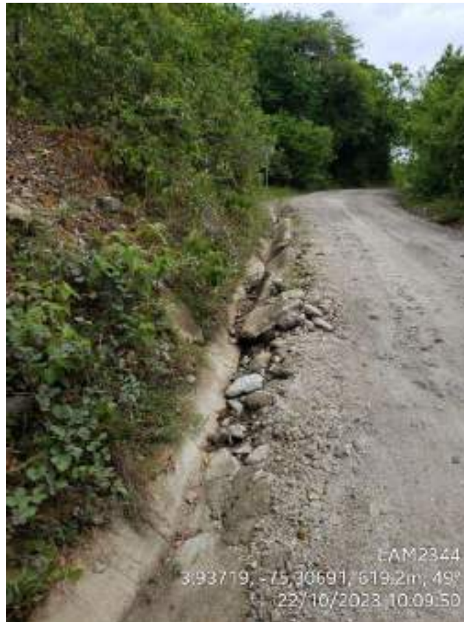
Fotografía 151. Campo Toy. Vía de acceso que conduce a la estación Toy. Nótese la cuneta completamente fracturada. Coordenadas Origen Único Nacional – E: 4743932 N: 1993414.
