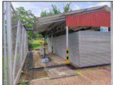
ER9: Generador Respaldo Estación Toldado
