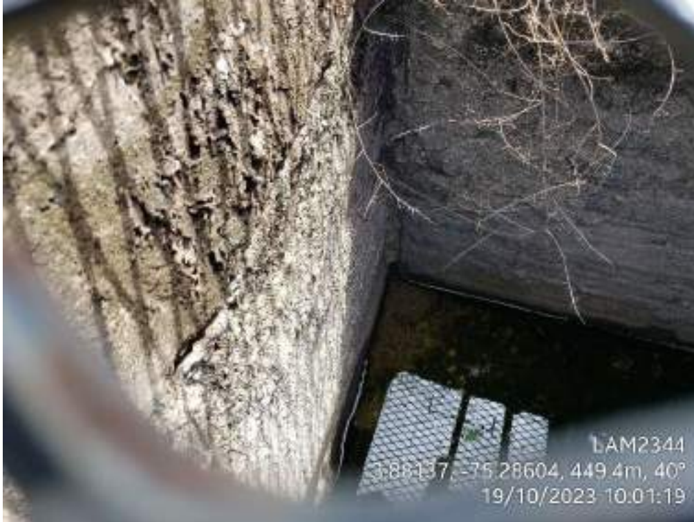
Fotografía 67. Plataforma Toldado 11. Nótese el contrapozo fracturado. Coordenadas Origen Único Nacional – E: 4746237 N: 1987236.
