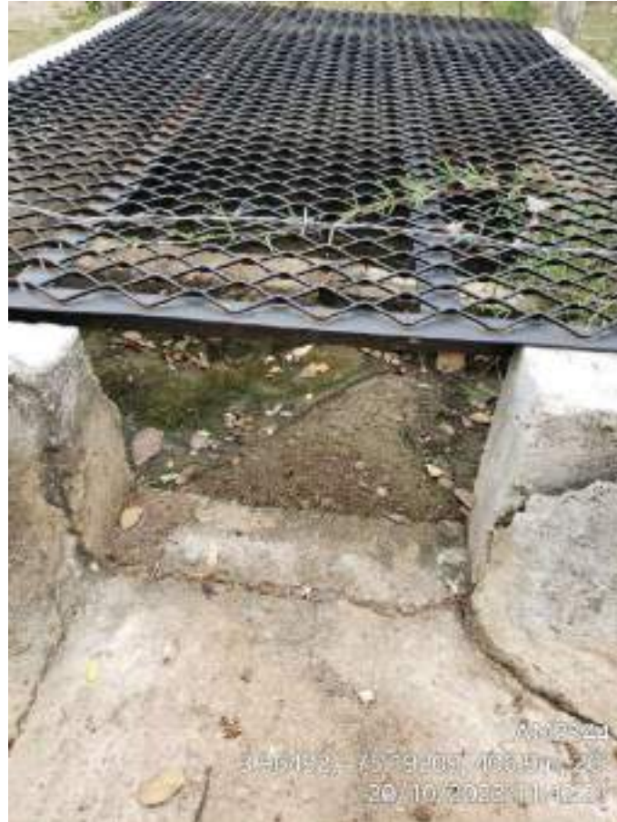
Fotografía 148. Ortega 13. Desarenador ubicado al costado Norte de la plataforma. Nótese la estructura completamente colmatada de sedimentos. Coordenadas Origen Único Nacional – E: 4756690 N: 1996447.
