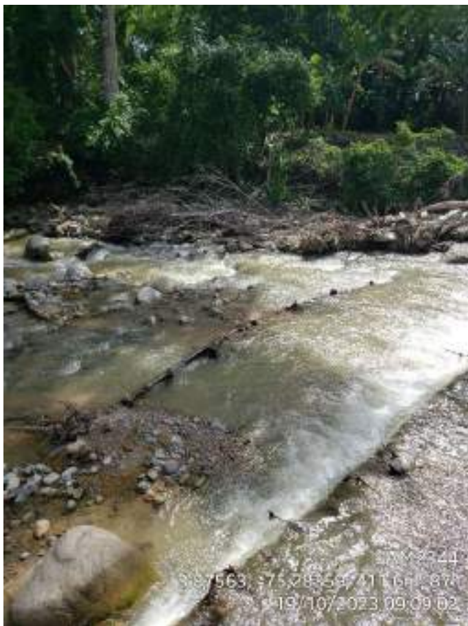
Fotografía 245. Cruce subfluvial del río Peralonso. Nótese la existencia de tubería de líneas de flujo abandonadas sobre el cauce del río. Coordenadas Origen Único Nacional – E: 4746495 N: 1986616.
