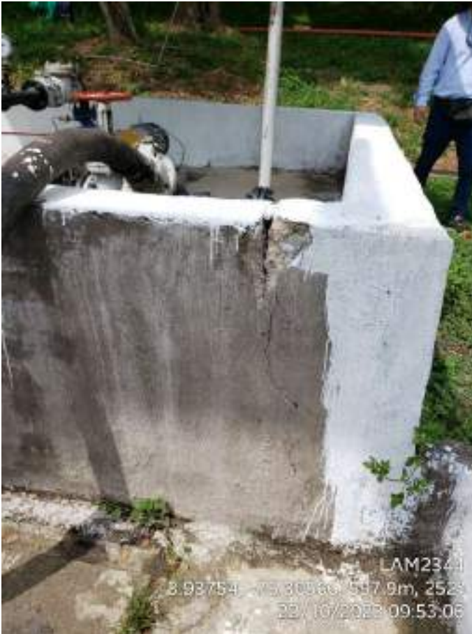
Fotografía 65. Estación Toy. Dique de las bombas utilizadas para el cargue de crudo. Nótese la pared del dique en concreto fracturada. Coordenadas Origen Único Nacional – E: 4744079 N: 1993456.
