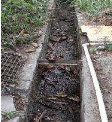
Fuente: ICA 27 \ Anexo 4.1.1 Mantenimiento de trampa de grasa \ C Registro Fotográfico
