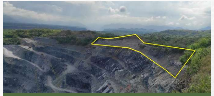
Fotografía. Talud con procesos erosivos activos entre el Retrolledado Chicalá y Piezómetro PZ-03. 4.290583N - 75.108466E WGS-84
