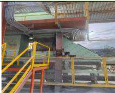
Fuente: ICA 27 \ Anexo 4.6.7 Mantenimientos de filtros de Mangas
