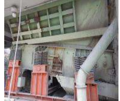
Fuente: ICA 27 \ Anexo 4.6.7 Mantenimientos de filtros de Mangas
