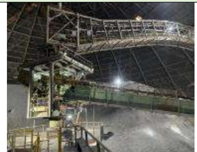
Fuente: ICA 27 \ Anexo 4.6.7 Mantenimientos de filtros de Mangas
