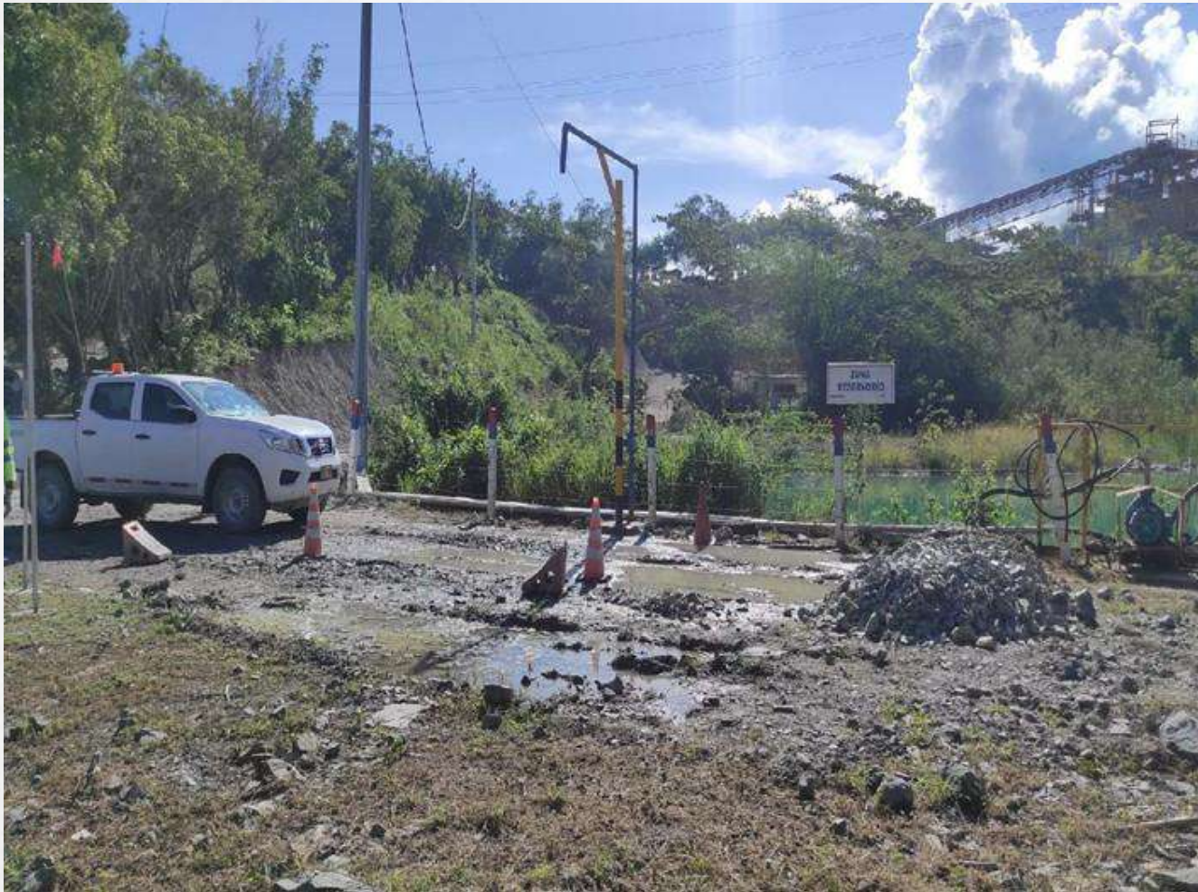
Fotografía. Punto de abastecimiento de agua de uso industrial para el riego de vías internas (zona reservorio). Mina La Esmeralda. 4.296629N -75.104485E WGS-84
