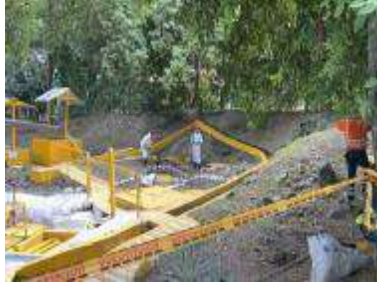
Fuente: ICA 27 \ Anexo 4.1.2 Mantenimiento anual STAR
