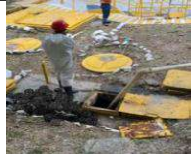
Fuente: ICA 27 \ Anexo 4.1.2 Mantenimiento anual STAR
