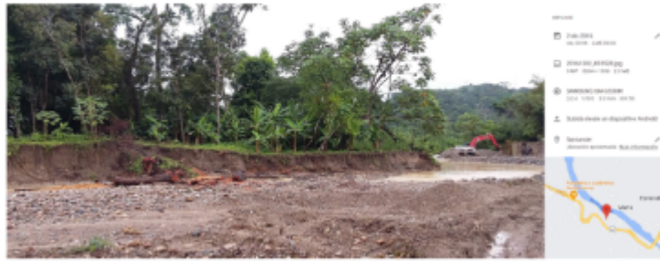
Obras terminadas en mayo del 2016 y en junio del mismo año, colapsaron por socavación.
