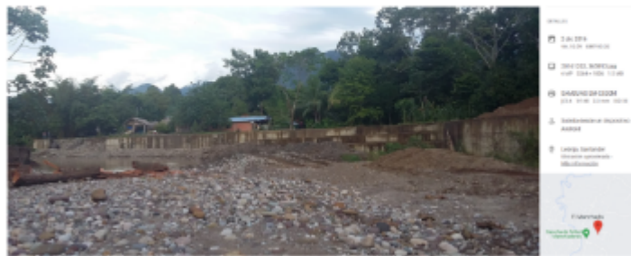
Obras terminadas en mayo del 2016 y en junio del mismo año, colapsaron por socavación, desembocadura de la quebrada Cabezonera al río Cauca.
