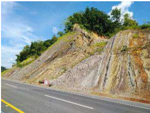
Foto 3 Talud 2+300 – 2+600 Coordenadas Magna Sirgas origen Bogotá, Este: 1059657 Norte: 1281041
