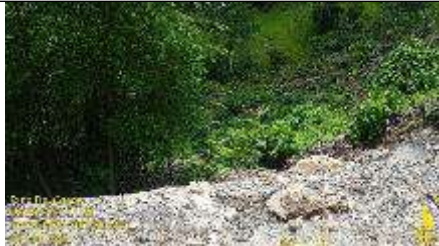
Foto 10 Material deslizado sobre terraplén (Coordenadas planas origen único 4966603.773E, 2349402.168N)
