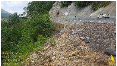
Foto 9 Terraplén con presencia de material de obra (Coordenadas planas origen único 4966594.605E, 2349506.92N)
