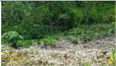
Foto 11 Terraplén con presencia de material de obra (Coordenadas planas origen único 4966623.31E, 2349365.79N)
