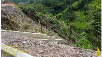
Foto 7 Terraplén con presencia de material de obra (Coordenadas planas origen único 496617.36E, 2349324.14N)
