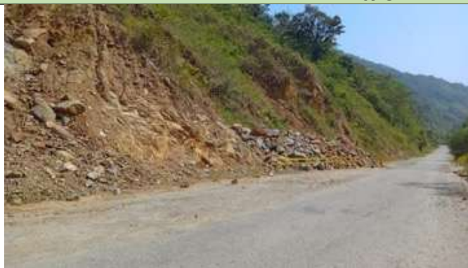
Fotografía 31. FOTO 2024-02-29 KILÓMETRO 8 - ROCAS AL LADO DE LA VÍA.jpg
