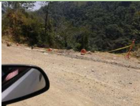
Fotografía 123. Fotografía 2024-02-28 SEÑALIZACIÓN MAL PUESTA
