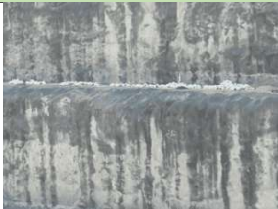
Fotografía 81. 2024-02-06 FRENTE MURO DE PRESA - BASURA.jpg
