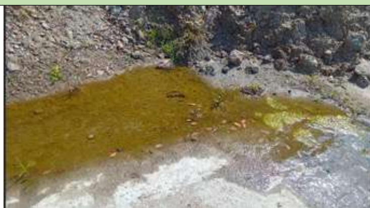
Fotografía 63. FOTO 2024-02-29 KILÓMETRO 15 - FALTA DE CUNETAS Y MANTENIMIENTO VÍAS
