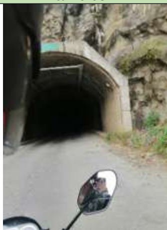
Fotografía 55. Foto 2024-02-06 falta de iluminación y señalización en túneles 4
