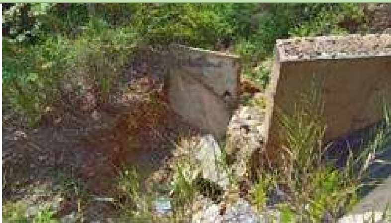
Fotografía 60. Foto 2024-02-29 kilómetro 8 - falta mantenimiento vías1
