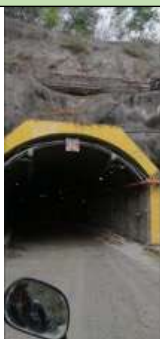
Fotografía 129. FOTO 2024-02-06 FALTA DE ILUMINACIÓN Y SEÑALIZACIÓN EN TÚNELES.
