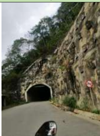
Fotografía 54. Foto 2024-02-06 falta de iluminación y señalización en túneles 3
