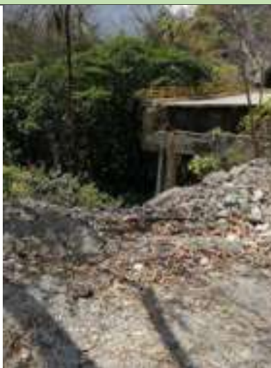
Fotografía 145. 2024-02-28 PUENTE EL BESO - SIN TERMINAR Y CON ESCOMBRO
