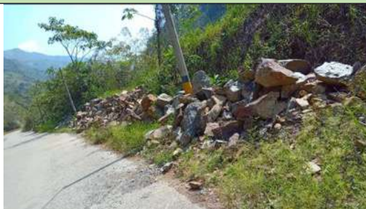
Fotografía 32. FOTO 2024-02-29 KILÓMETRO 10 - ROCAS AL LADO DE LA VÍA.jpg
