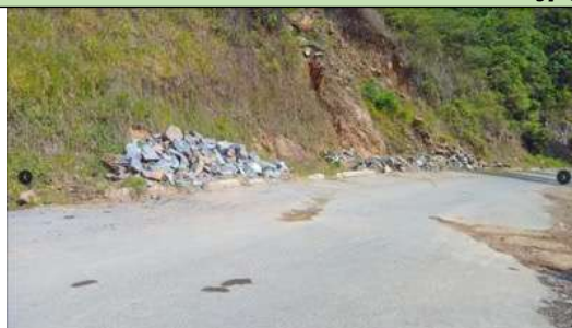
Fotografía 33. FOTO 2024-02-29 KILÓMETRO 12 - ROCAS AL LADO DE LA VÍA2”.jpg
