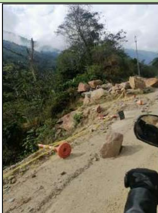
Fotografía 27. 2024-02-06 VÍA DEL TÚNEL 0 HACIA LA PRESA - PIEDRAS EN LA VÍA.jpg
