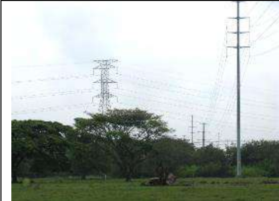
Fotografía 19 Infraestructura eléctrica asociada a los circuitos Juanchito – Salvajina 220 kV y Juanchito Pance 220 kV y Alférez I – Meléndez 115 kV y Alférez I – Pance 115 kV.
