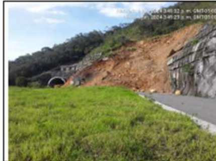
Descripción: Calzada izquierda del Portal Salida – Túnel falso totalmente cubierto por el material desprendido. Fecha: 06 de junio 2024
