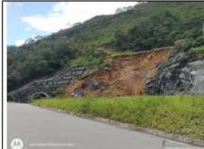
Descripción: Túnel falso de calzada izquierda totalmente tapado. Foto tomada desde la calzada derecha. Fecha: 28 de mayo del 2024
