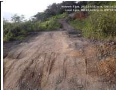
Descripción: vía veredal de San Miguel, se evidencia el movimiento del terreno, se continua con el transito vehicular por el sector. Fecha: 06 de junio 2024
