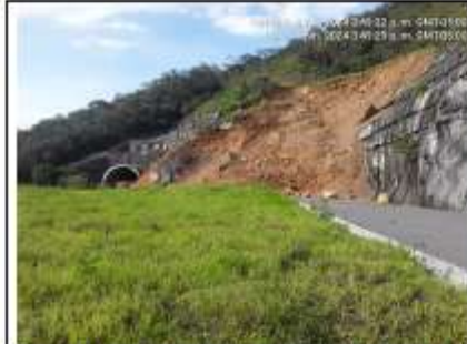
Descripción: Calzada izquierda del Portal Salida – Túnel falso totalmente cubierto por el material desprendido. Fecha: 06 de junio 2024
