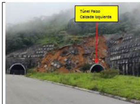
Descripción: Se puede observar el deslizamiento del talud frontal de calzada izquierda, sobre el túnel falso. Fecha: 19 de mayo del 2024
