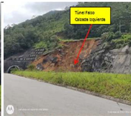
Descripción: Se puede observar el deslizamiento del talud frontal de calzada izquierda, ha sido progresivo y tapo el túnel falso. Fecha: 21 de mayo del 2024
