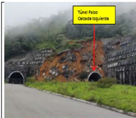
Descripción: Se puede observar el deslizamiento del talud frontal de calzada izquierda, sobre el túnel falso. Fecha: 19 de mayo del 2024
