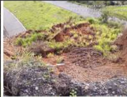
Descripción: Vista de la parte alta del talud portal Salida – túnel 8. Fecha: 06 de junio 2024
