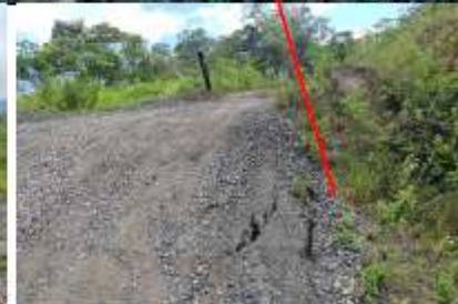
Descripción: Esta grieta bien desde el portal salida y se extiende forma vertical hacia la conformación de macizo. Fecha: 19 de mayo del 2024
