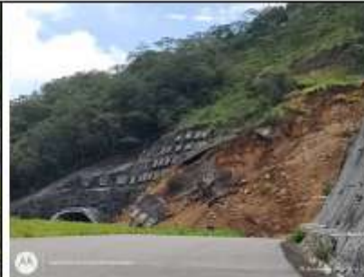
Descripción: Túnel falso de calzada izquierda totalmente tapado. Foto tomada desde la calzada izquierda. Fecha: 28 de mayo del 2024
