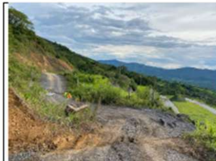
Descripción: Vista de la vía veredal de San Miguel, se evidencia el desplazamiento del suelo y colapso de obras hidráulicas de la vía. Fecha: 06 de junio 2024
