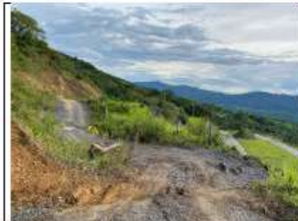
Descripción: Vista de la vía veredal de San Miguel, se evidencia el desplazamiento del suelo y colapso de obras hidráulicas de la vía. Fecha: 06 de junio 2024
