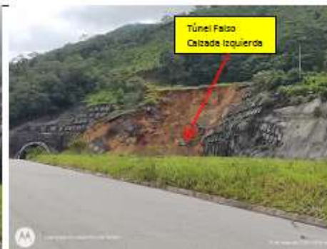
Descripción: Se puede observar el deslizamiento del talud frontal de calzada izquierda, ha sido progresivo y tapo el túnel falso. Fecha: 21 de mayo del 2024
