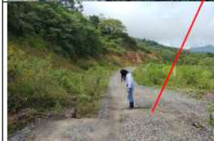
Descripción: Esta grieta bien desde el portal salida y se extiende forma vertical hacia la conformación de macizo. Fecha: 19 de mayo del 2024
