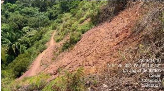
Fotografía. Derrumbe predio La Florida.
