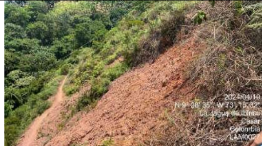
Fotografía. Derrumbe predio La Florida.
