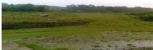
Control del talud realizado el 26 de agosto de 2011 talud en reposo final
