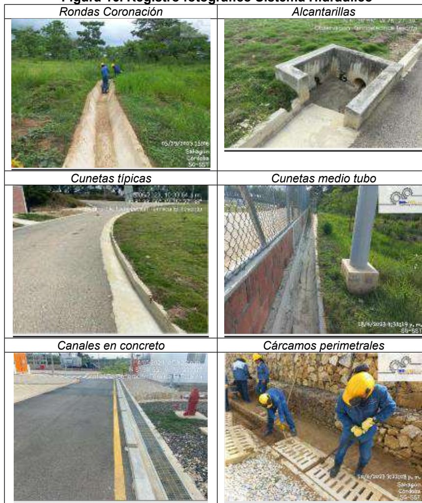
Figura 16. Registro fotográfico Sistema Hidráulico
