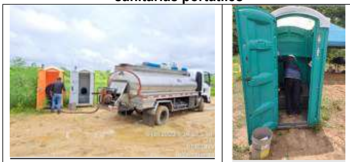
Figura 6. Registro fotográfico de instalación y mantenimiento de unidades sanitarias portátiles
